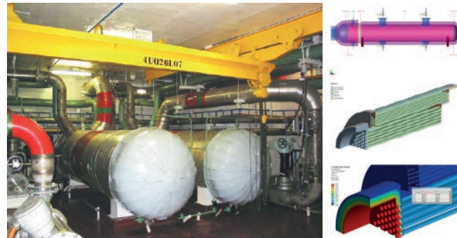
ČEZ, A. S. – JE DUKOVANY – CHLADIČ SKLADOVACIEHO BAZÉNA
