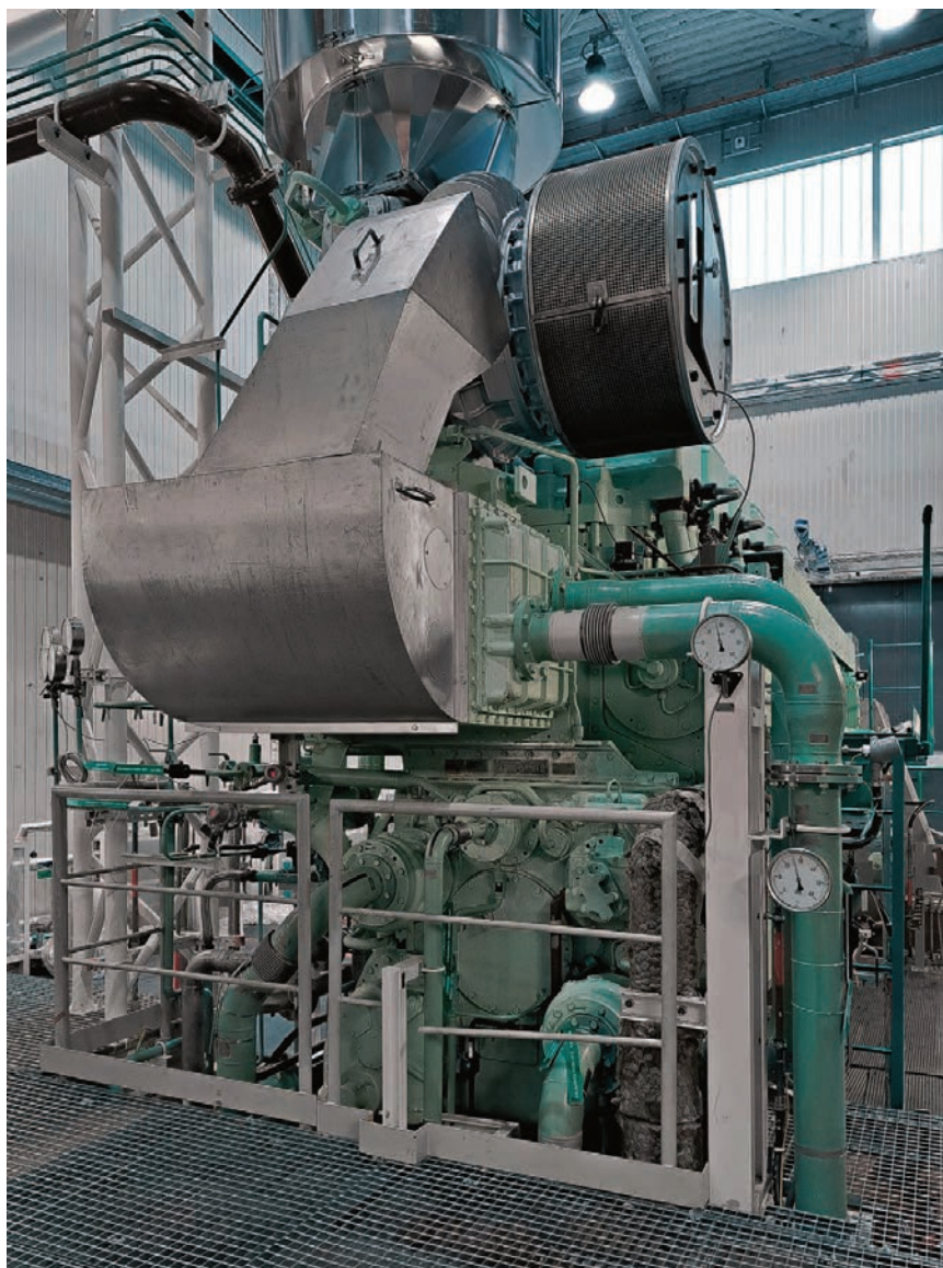
Motor núdzového diesel-generátora
