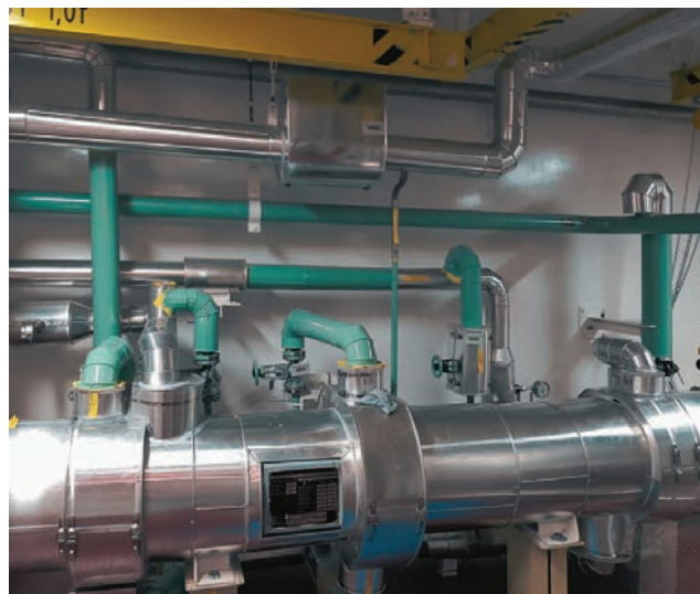
Chladič vykurovacej pary odplyňovávok
